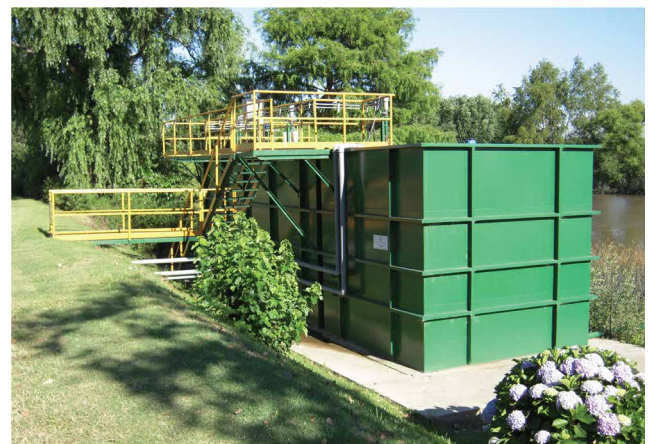
Planta Compacta Secuencial para Efluentes Cloacales de Club Náutico.
