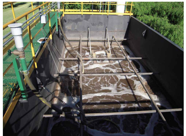
Reactor SBR en etapa de aireación.
