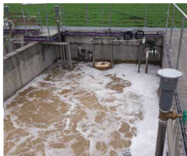
Reactor SBR completamente automatizado.
