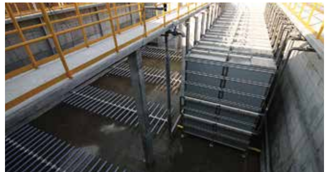
Módulos membrana MBR en cámara de aireación.
